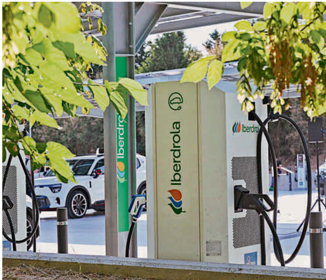
Puntos de recarga de Iberdrola.
