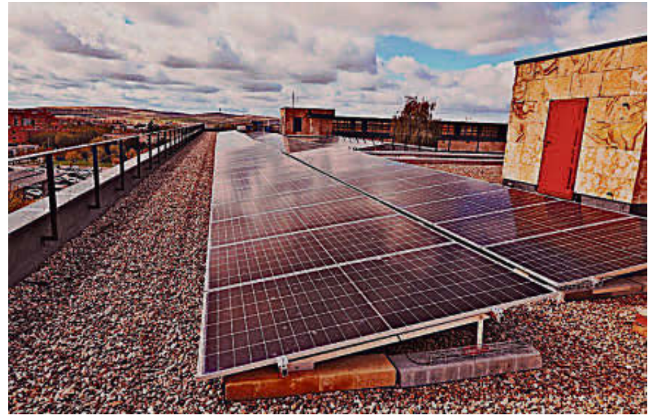
Placas solares situadas en la cubierta de la Facultad de Derecho. ARCHIVO
