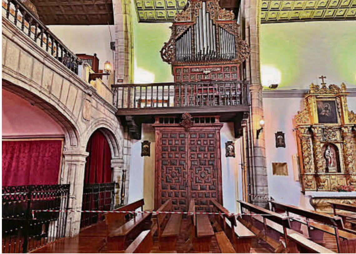
Imagen de la zona acordonada junto al órgano de Santa María por prevención ante el riesgo de derrumbe. TEL
